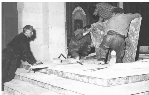
Les derniers travaux à l'intérieur de l'église remontent à la fin des années 1950. On voit ici le père Delpierre, en soutane, porter main forte aux ouvriers.
